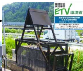
水車・発電機 ▶
