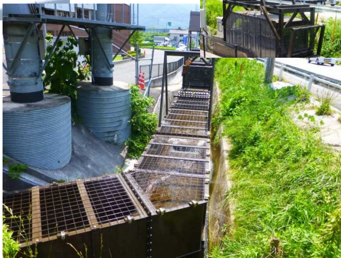
発電所設置後の現況 ▶
